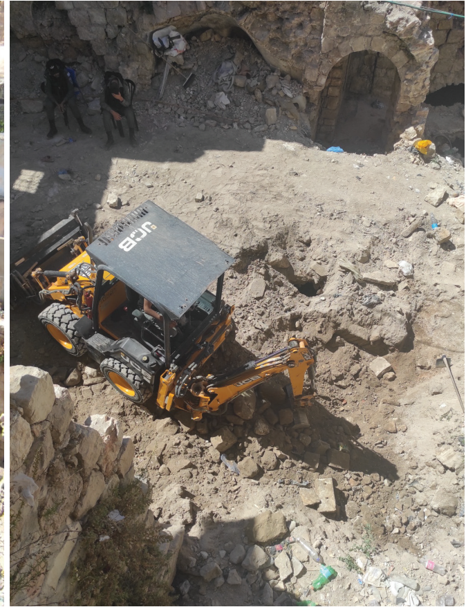
جرافة المستوطنين أثناء هدمها لحوش الشريف وقضيشة
